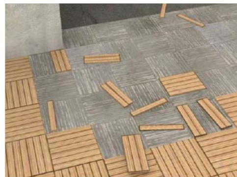
Décollement généralisé d'un parquet mosaïque collé sur béton.
